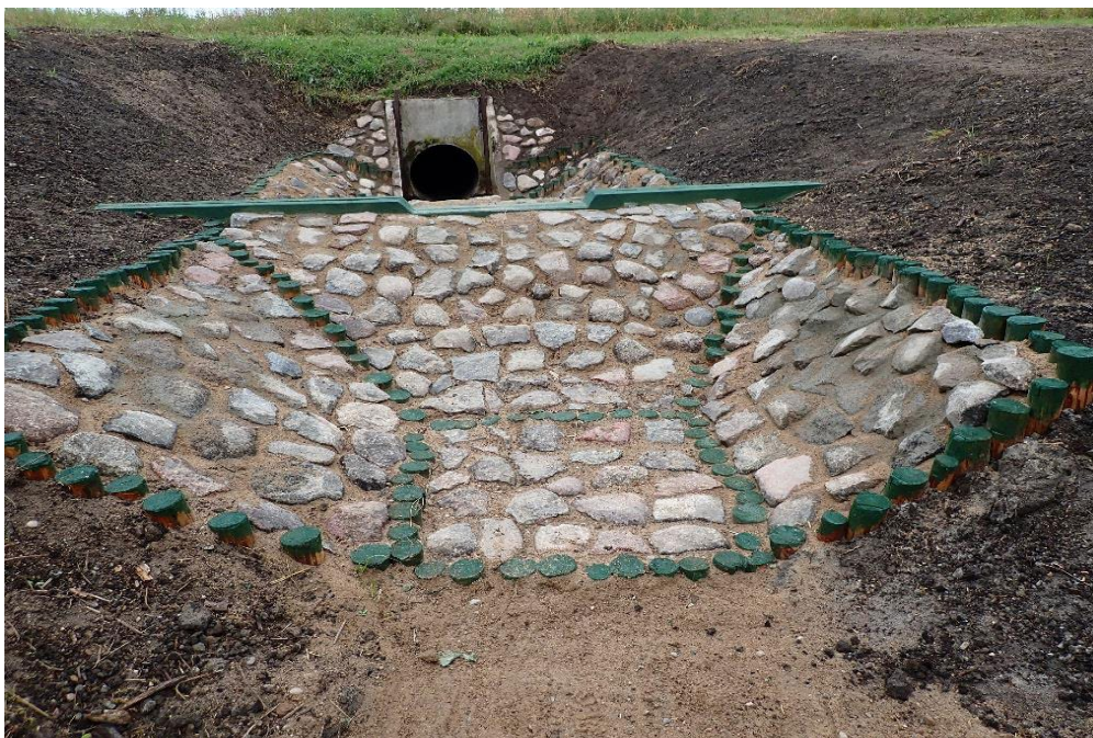
Fot. 10. Próg piętrzący w rowie odwadniającym w Nowych Sadach / Photo 10. The dam in a drainage ditch in Nowe Sady
