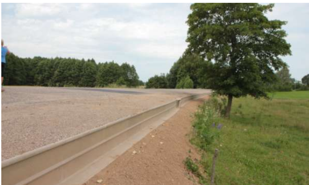
Fot. 2. System przepustów dla pólazów w miejscowości Skajzgiry (II)
